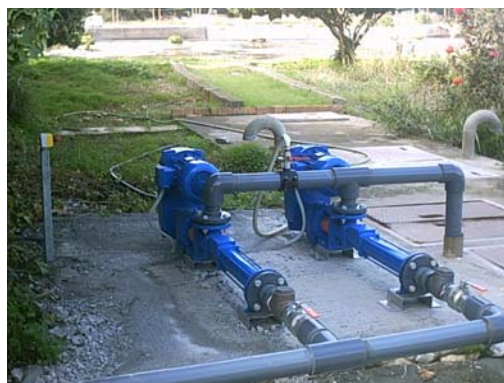
Εξωτερικό αντλιοστάσιο ιλύος ΕΕΛ Αγ. Νικολάου.
