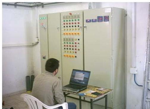
Πίνακας διανομής ισχύος και αυτοματισμών λειτουργίας.
